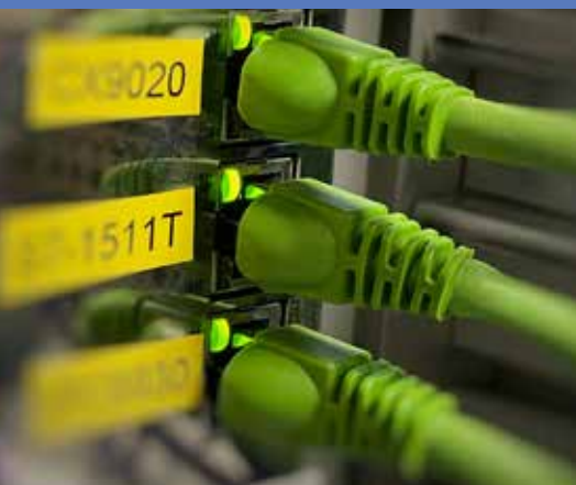
Netzwerkanschluss - network connection
